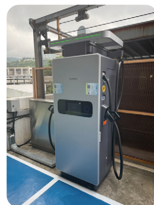
在中染大廈停車場的電動車充電設施
